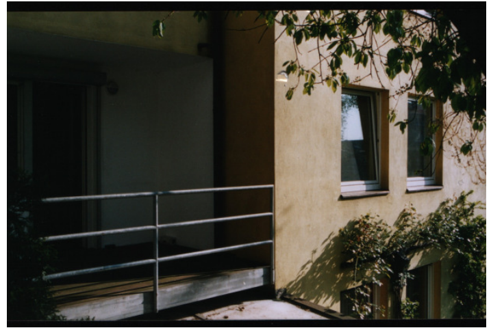
Die Schimmelecke von außen.
