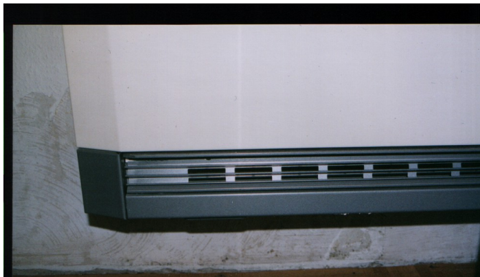
Schimmel an der Wand direkt am Heizkörper.
